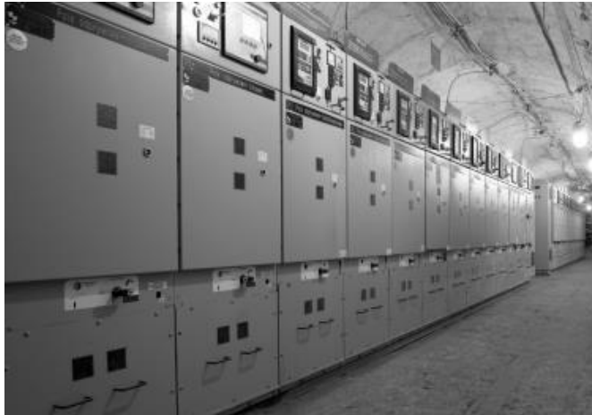
Rys. 1 Rozdzielnia główna 6kV R-404 Figure 1. Main switchgear 6kV R-404
